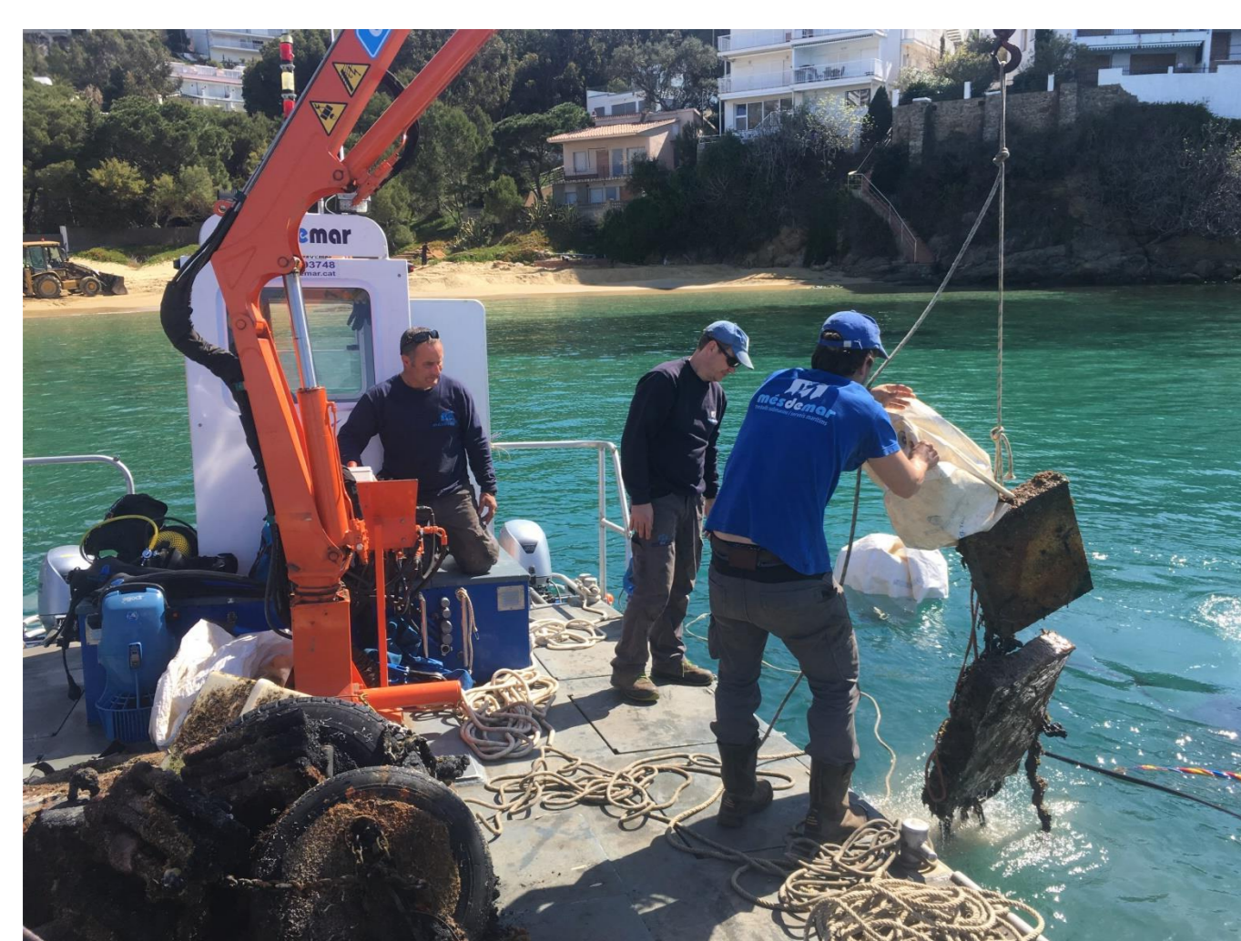
Figura 10: Extracción de los muertos de fondeo mediante el uso de un barco con grúa.
